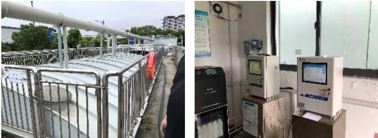
图 4.1-1 污水处理站照片
