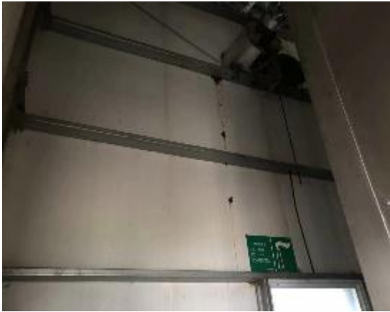
危废库废气治理设施
