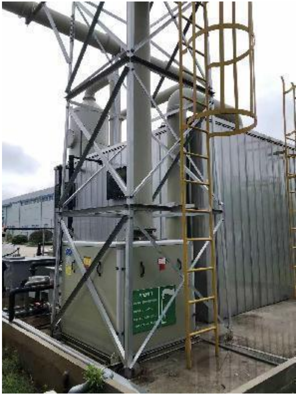
污水处理站废气排口
