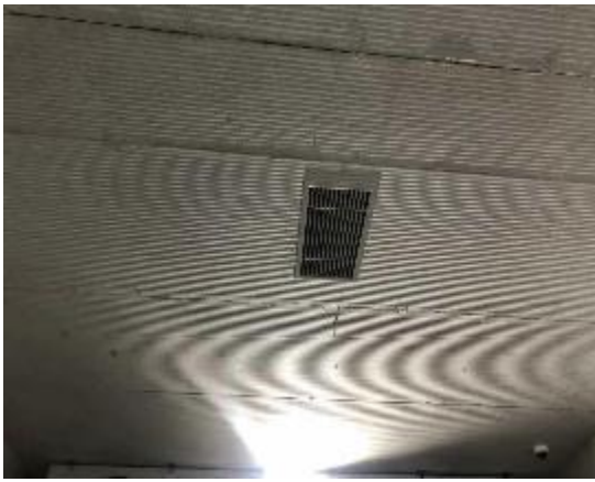
危废库废气治理设施
