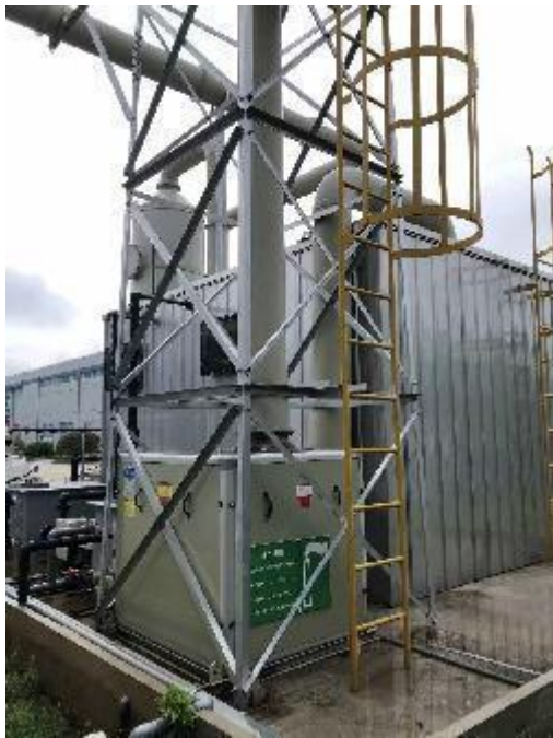
污水处理站废气治理设施
