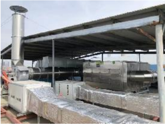
动物房废气治理设施
