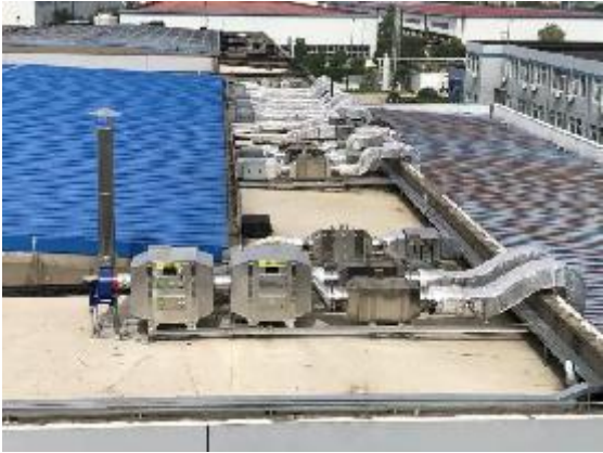
活苗车间废气治理设施
